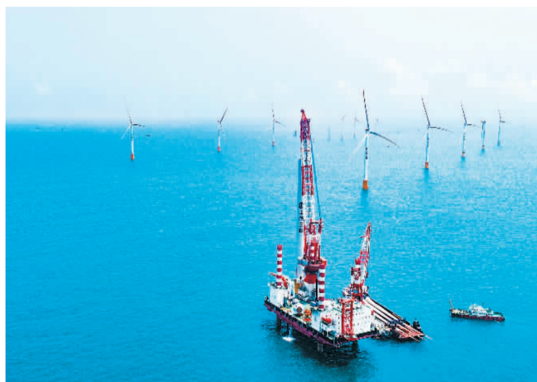
建设中的三峡新能源阳江发电公司海上风电机组。赖增鹏摄
