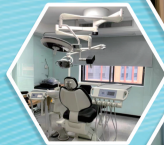
先進醫療設備
