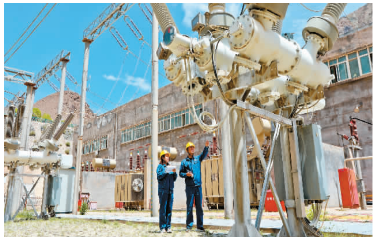
6月25日，甘肃投河西水电公司张掖龙首一级水电站的工作人员在检查变电站运行情况。 王将摄（人民视觉）
