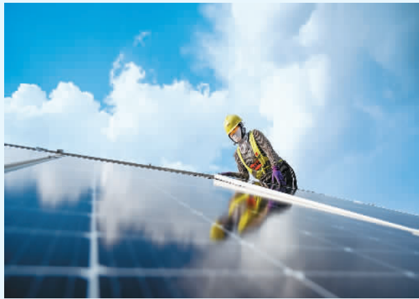
位于内蒙古伊金霍洛旗乌兰木伦镇的天骄绿能50万千瓦光伏发电项目，是采煤沉陷区生态治理光伏发电示范项目，目前已进入收尾阶段。图为工人在安装光伏板。新华社记者 刘 磊摄
