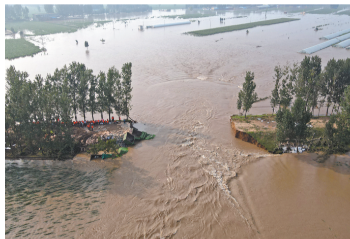
7月23日，位於河南省鶴壁市浚縣馬頭村附近的衛河鶴壁段堤壩出現近40米長缺口。
