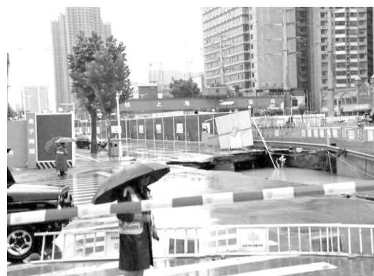
2021年7月21日,暴雨致郑州城区大学南路道路塌方,交通阻断。中新社发 王中举 摄
