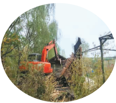
山东省东营市东营区龙居镇执法中队拆除黄河滩区内违法建筑。
