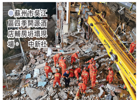
●蘇州市吳江區四季開源酒店坍塌現場。中新社
