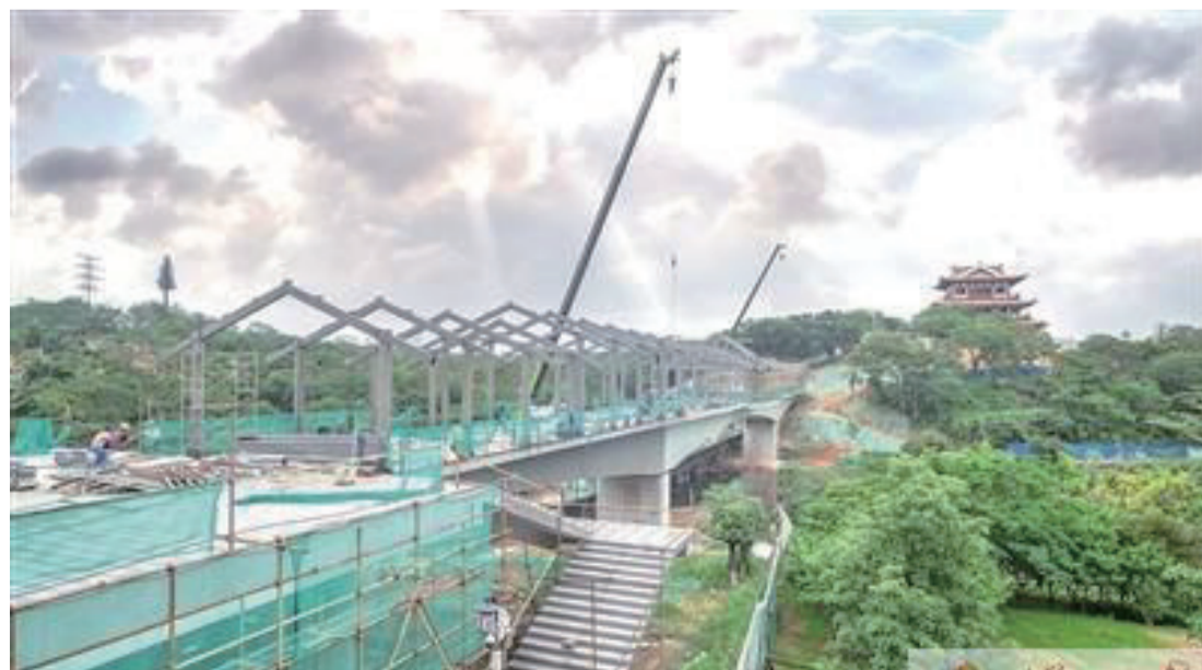
連日來，總投資3600萬元的經溪公園一期續建劉克莊文化園、狀元閣、狀元橋工程總承包項目加緊施工，建成之後將為游客帶來更加便捷的游園體驗。圖為正在建設中的狀元橋。蔡昊 攝
