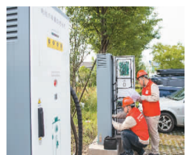
在江苏省海安市曲塘镇一国网充电点，技术人员对新装的充电桩进行调试。翟慧勇摄（人民图片）
