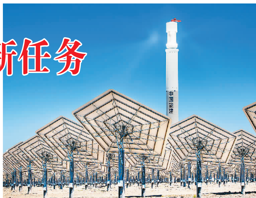
图为5月23日,在新疆哈密市伊吾县淖毛湖镇戈壁上的光热工业园区内,中国能建投资公司投资建设的哈密50兆瓦熔盐塔式光热发电站进行调试定镜工作。哈密光热项目建成后,预计每年可提供1.98亿千瓦时的清洁电力。李华撰(人民视觉)
