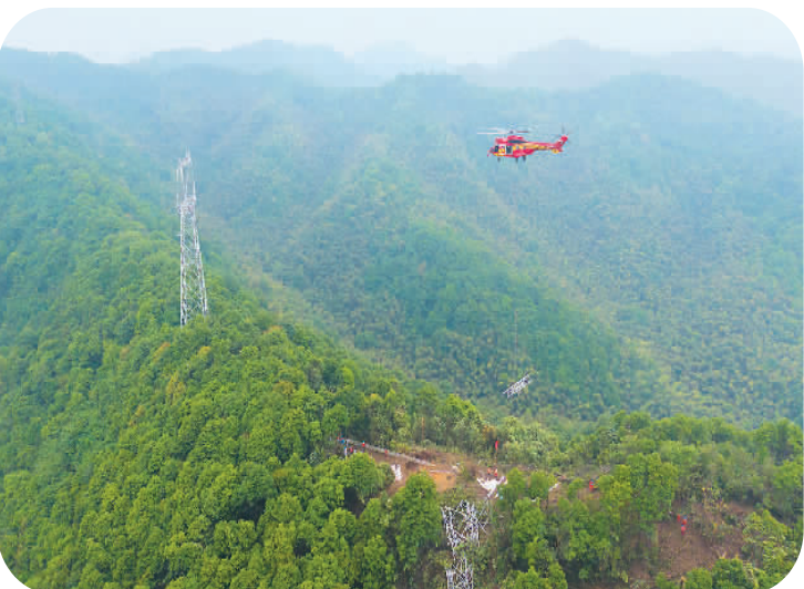
日前,浙江省绍兴市局部地区出现极端强对流天气,造成兰风线6基铁塔受损,国网浙江电力公司引入直升机参与抢险,这也是国内电力领域首次采用直升机进行抢险作业。 王浩摄
