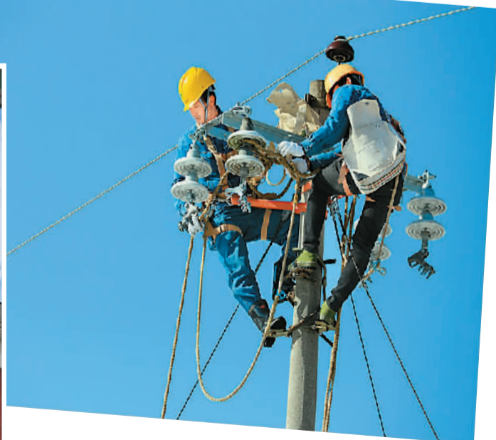
▲ 壶瓶山供电所工人周长勇（左）、谭功波在石门县南北镇白竹山村开展电网改造施工。 资料照片
