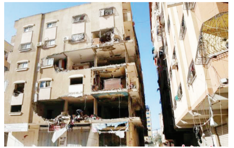
当地时间5月15日,巴以冲突期间,加沙地区当地民众在损毁的房屋内清理物品。
