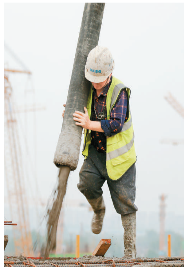
▲ 在河南洛阳，中建八局承建的洛阳市奥林匹克中心项目上，一位工人正为体育场五层梁板浇筑混凝土。 王光晨、白新宇摄
