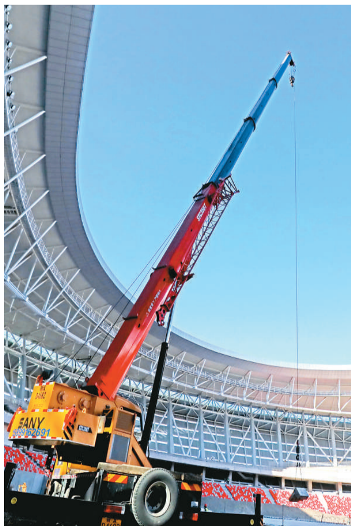
近期，随着各场馆设备安装逐步到位，新加坡奥林匹克体育中心工程进入收尾阶段。该体育中心总投资三十八亿元，包括体育场、体育馆、田径馆、全民健身馆、运动员公寓等六个单体建筑，同时配套建设体育公园和丝路平台。图为四月十二日，工人在吊运预制台阶段。 蔡增乐摄（人民视觉）
