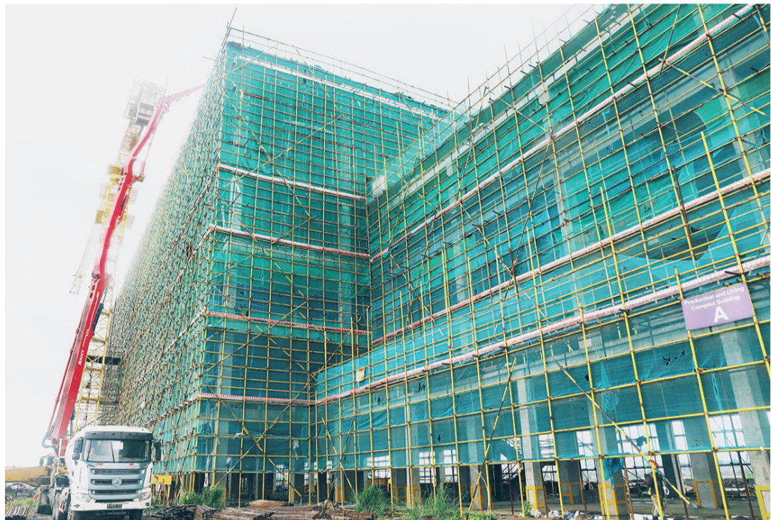
雅万高铁 Tegal-Luar (德卡鲁尔) 动车所站房综合楼 A 楼成功封顶
