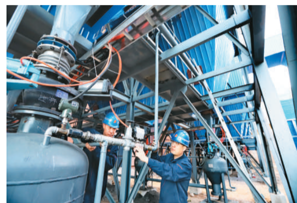
为落实好“打赢蓝天保卫战三年行动计划”，辽宁省锦州市进一步加大对供暖设备的技术改造力度。图为锦州热力集团的工作人员在巡检设备。 蔡社摄（人民图片）
