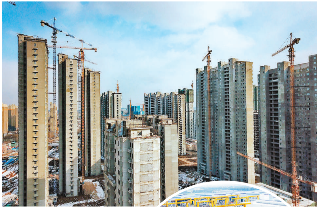
▲2月22日，吉林省长春市生态大街附近的一处在建楼盘正在施工。 新华社记者 张楠摄
