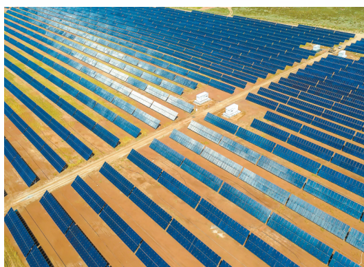
伊泰50MWp光伏發電項目
