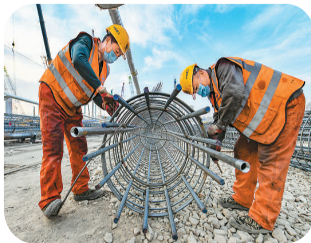
▲北京城市副中心站综合交通枢纽工程建成后,京唐城际、京滨城际等将在这里交会。图为2月19日,工人正在北京城市副中心站综合交通枢纽施工现场忙碌。 孙立君摄(人民视觉)
