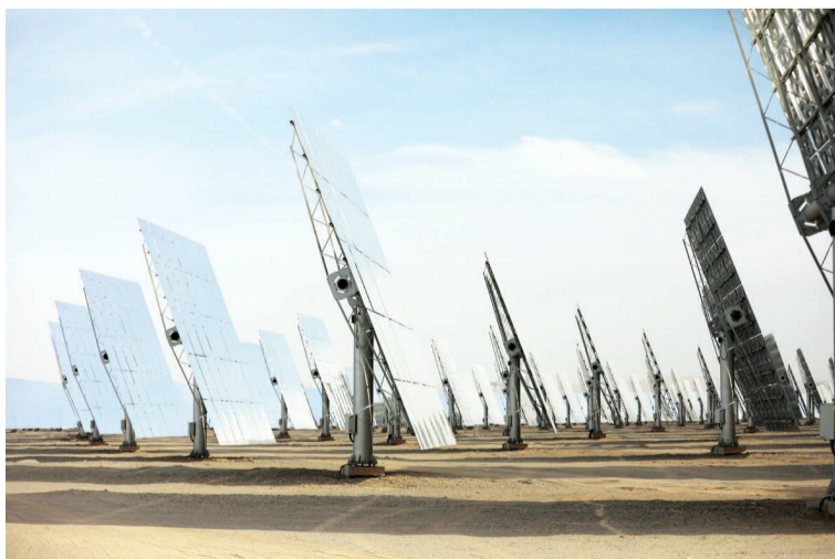
2月23日拍摄的敦煌100兆瓦熔盐塔式光热电站
