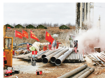
山東棧橋山金礦爆炸事故現場。
