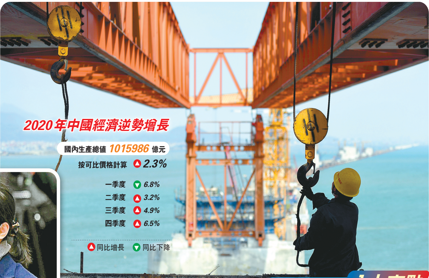
▲ 中鐵十一局工人在新建福廈鐵路涇洲灣跨海大橋建設現場施工。新華社
