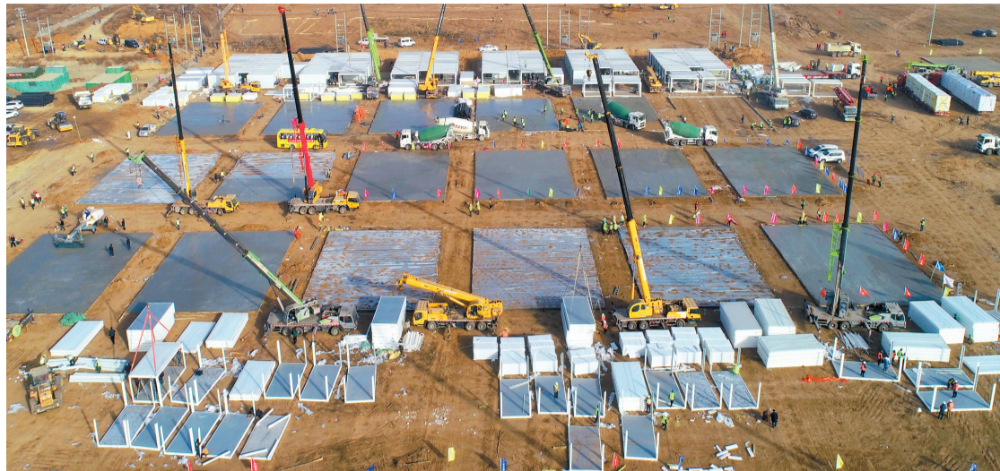
1月15日，工人在石家莊黃莊公寓隔離場所項目工地施工（無人機照片）。新華社
