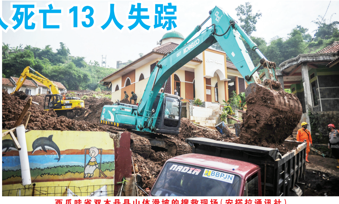
西爪哇省双木丹县山体滑坡的搜救现场(安塔拉通讯社)
