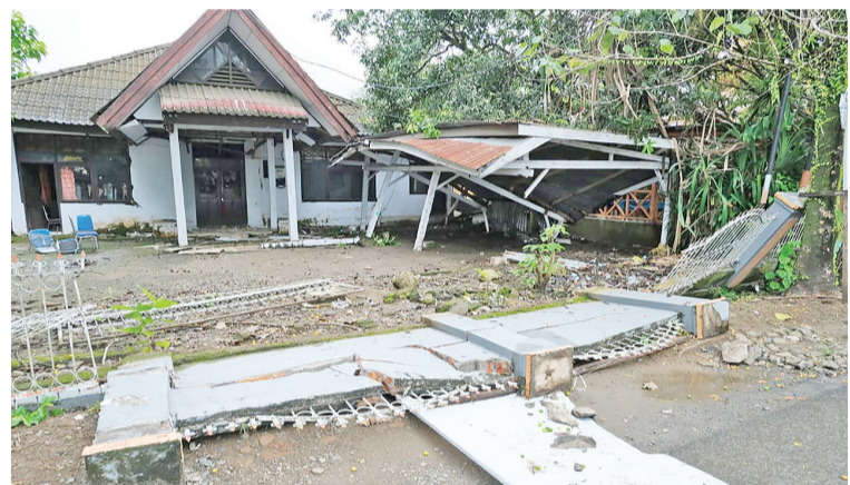
1月15日在西苏拉威西省马穆朱拍摄的在地震中损毁的房屋。新华社(萨德利·阿沙里·赛义德摄)
