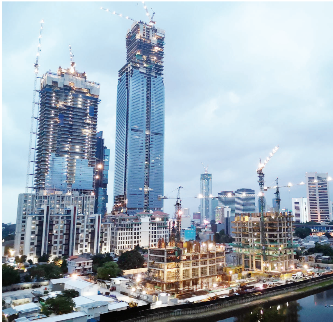
华灯初上，雅加达市中心的一个建筑工地准备进入夜间施工
